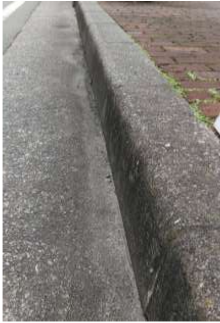
やすらぎ行きのバス停:段差が20cmと高い。一旦この段差を降りてからバスに乗り込むため高齢者に負担。
