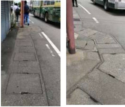
宇治山田駅～伊勢市駅歩道:歩道というより側溝のふたの上を通る感じ。通路上に標識などのポールあり。
